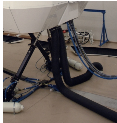
تهویه مطبوع کابین از طریق لوله های انعطاف پذیر
